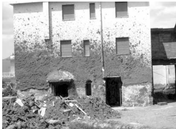
FIGURE 1.12: Marques d'éclaboussures des coulées de boues sur une maison de Quindici (Revellino et al., 2004)
