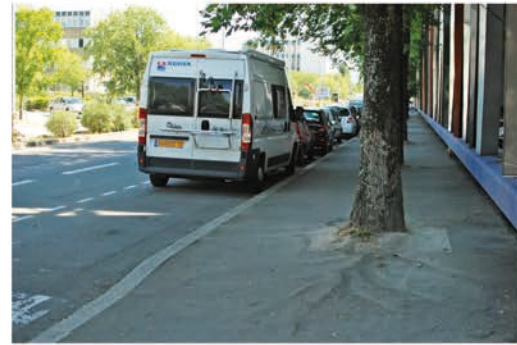
3 : Bande le long de l'Avenue, sol des trottoirs dégradé
