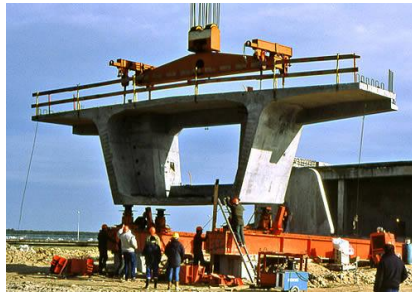
Application du principe : décomposer l'ouvrage d'art en voussoirs. (ici pour le pont de l'île de Ré)
