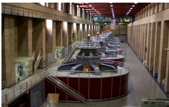
Salle des générateurs, barrage Hoover (Arizona)
