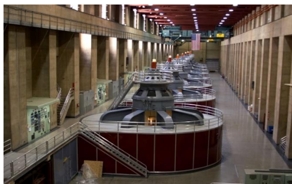
Salle des générateurs, barrage Hoover (Arizona)
