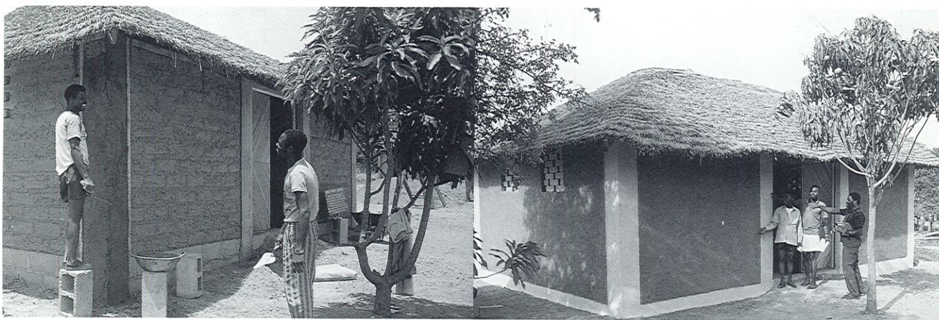
Lancement d'une filière terre régionale dans l'Etat de Plateau, au Nigéria. Valorisation et réactualisation des cultures constructives et des matériaux traditionnels (adobe, enduits en terre).
