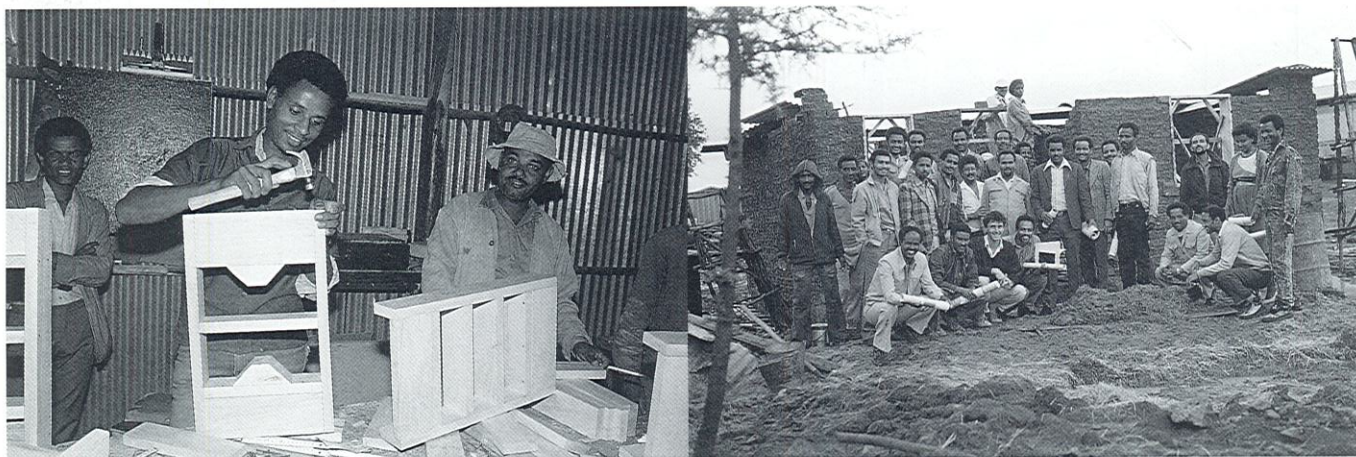
Formation de techniciens de chantier en Ethiopie avec amélioration de la qualité des matériaux et mise au point de nouvelles solutions constructives en maçonnerie armée grâce à l'emploi de blocs spéciaux avec l'Unité d'architecture pour l'éducation de l'UNESCO.
