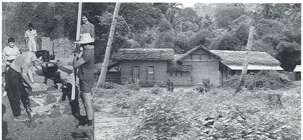
Lancement de la filière terre à Mayotte (Comores). Prospection des carrières, mise en exploitation, montage des briqueteries, formation des briquetiers et des briqueteurs sur un chantier-pilote.
