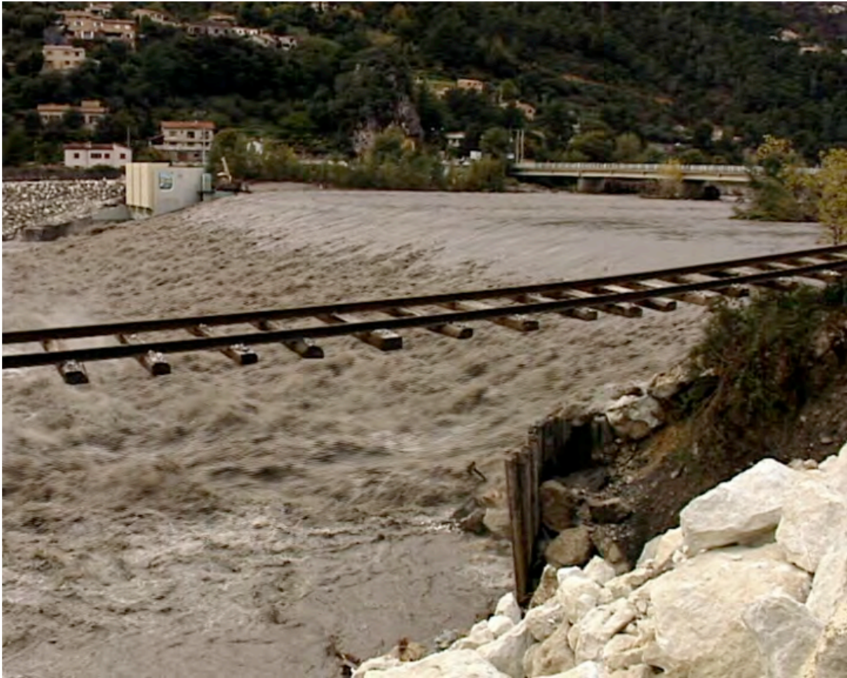
Désordre au niveau du pont Charles Albert (photographie © DDE06)
